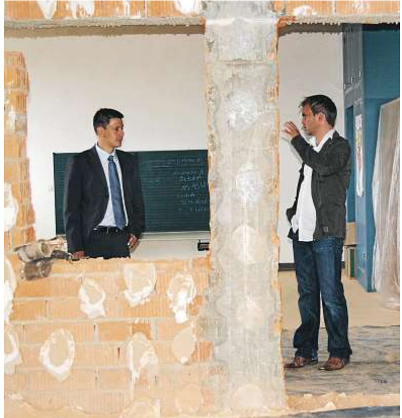
Zweiter Bürgermeister Wolfgang Weigert und Architekt Joachim Gutthann informierten sich über den Stand der Umbauarbeiten. Foto: Schmid
